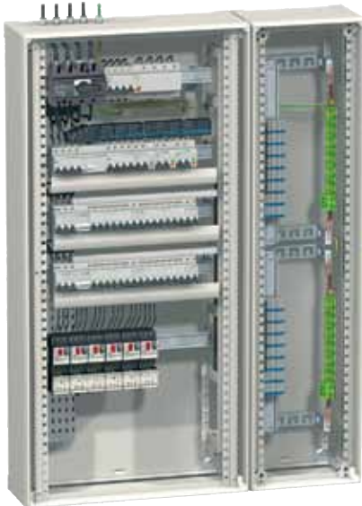
Вводной аппарат в силовом распределительном щите Prisma
